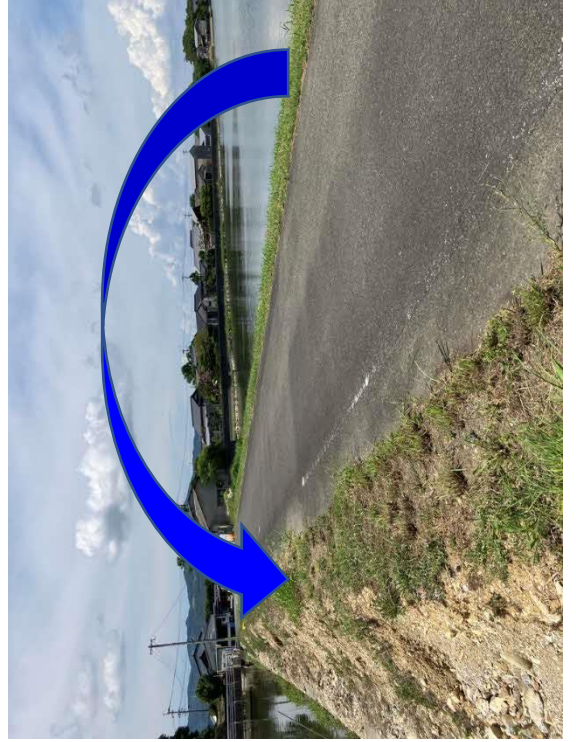
⑦ 未整備 ※八間川越水により洗堀
