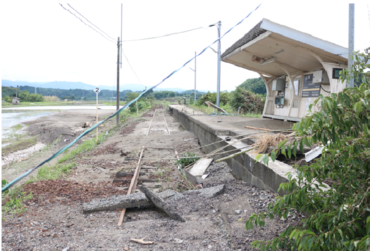
相良村川村駅 かわむら （被災状況）
